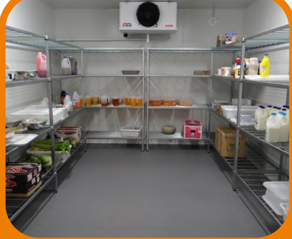
Evaporator Fan مبخر
