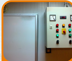
Control Panel لوحة كهرباء
